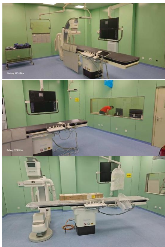
机房内部及设备
