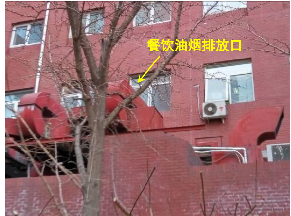
营养食堂油烟排放口
