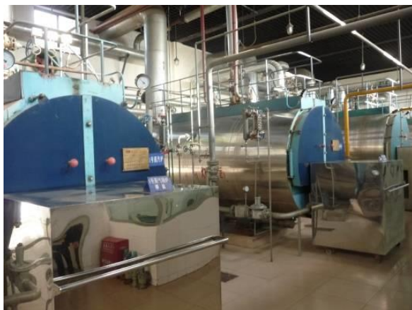
燃气锅炉房内景
