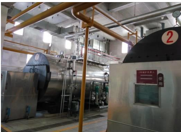
燃气锅炉房内景
